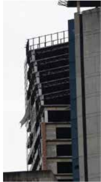
۱۸/۰۸ Mw، ساختمان ۴۲ طبقه، ونزوئلا، ۱۸/۰۸
